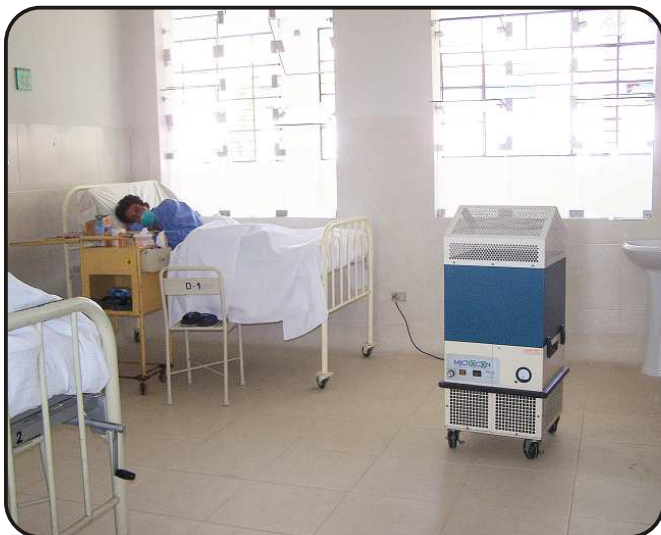
Hospitalización equipado con filtros Hepa
